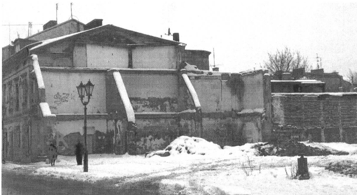
Ryc. 59. Stan techniczny zabudowy przy ul. Starowarszawskiej
