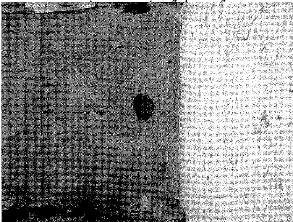
Dziura w ścianie szczytowej do zamurowania
