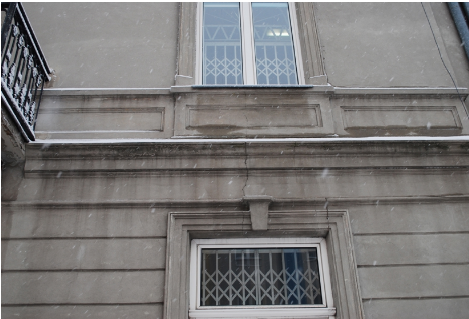
Fot. 5 Spękania konstrukcyjne
