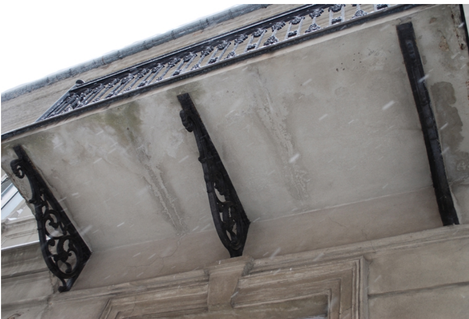
Fot. 6 Zacieki na spodniej stronie płyty balkonu świadczące o braku izolacji i nieskutecznym odprowadzeniu wody
