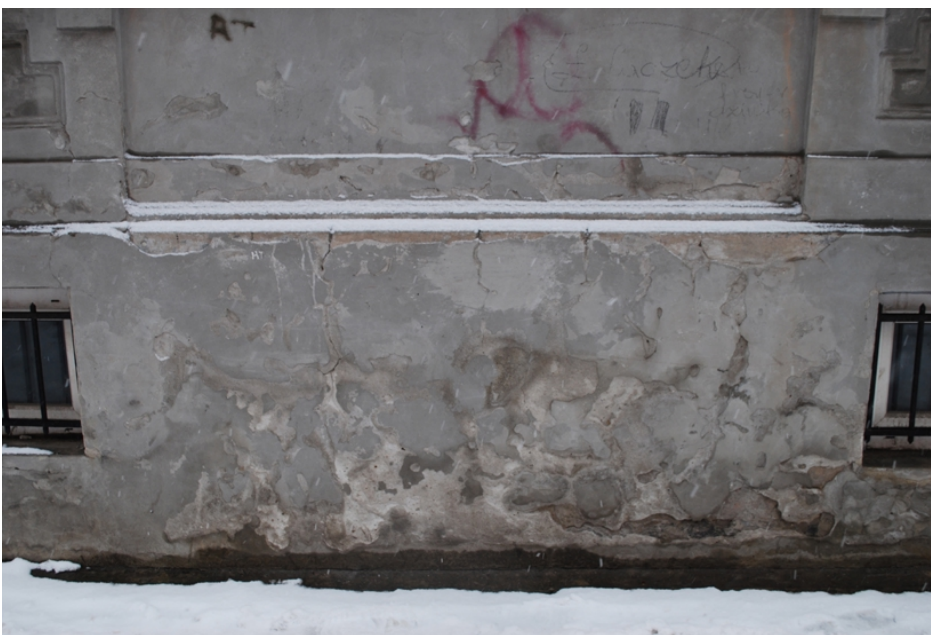
Fot. 2 Uszkodzenia tynku w strefie cokołowej
