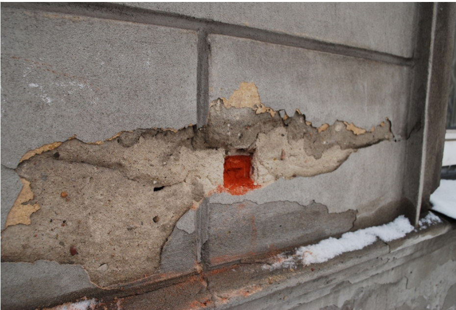
Fot. 3 Uszkodzenia tynku wapiennego powyżej strefy cokołowej – miejsce pobrania próbki 2
