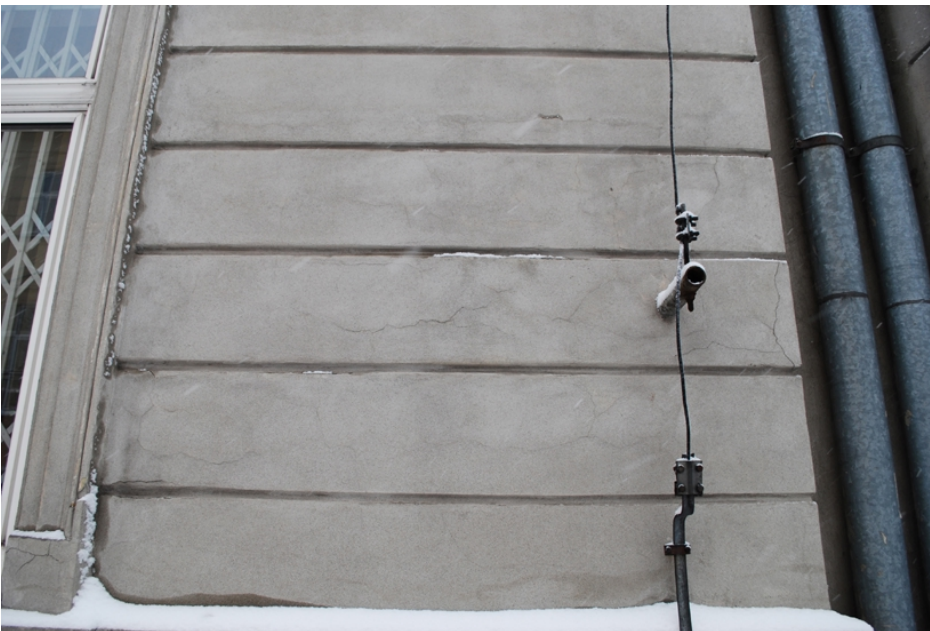
Fot. 4 Odspojona przecierka cementowa
